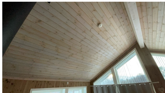
Overflatebehandling på panel i himling er ujevn.
