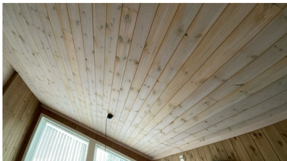
Overflatebehandling på panel i himling er ujevn.
