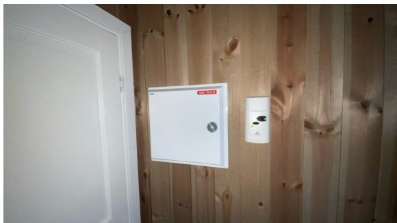
Sentral ved sikringsskap
