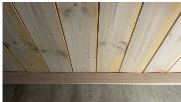
Silikonrester i himling over overskap på innredning
