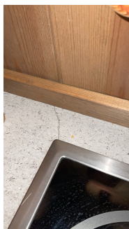
Sprekk i benkeplate ved platetopp
