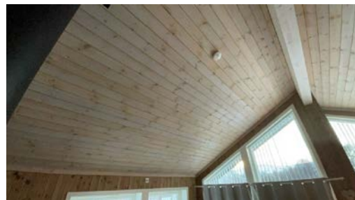
Overflatebehandling på panel i himling er ujevn.
