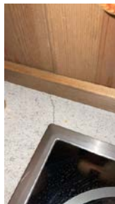
Sprekk i benkeplate ved platetopp
