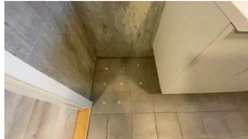
Flis med bom/hullyd er markert, det er mellom dør og innredning
