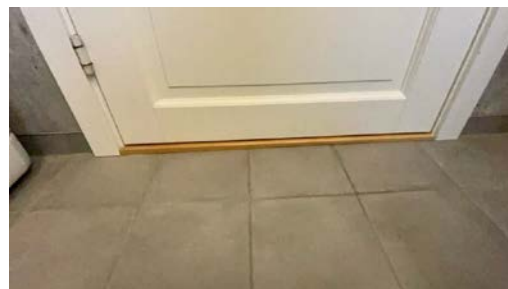
Luftespalte under dør
