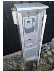
Utvendig inntaksskap med hovedbryter, AMS strømmåler og overspenningsvern
