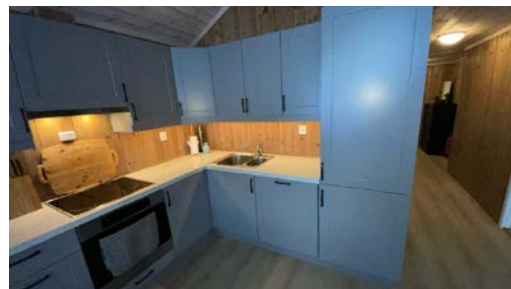
Oversikt. Anbefaler å få montert sprutplate/vannsikker overflate på vegg ved vask og platetopp.
