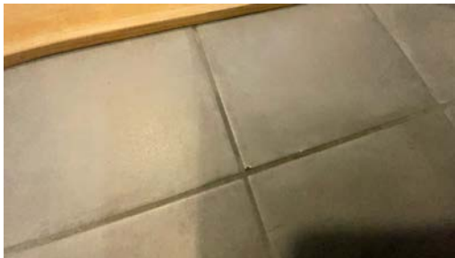
Liten kantskade på ei flis ved dør
