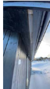
Synlig luftespalte i raftekasse ved overgang tak/vegg
