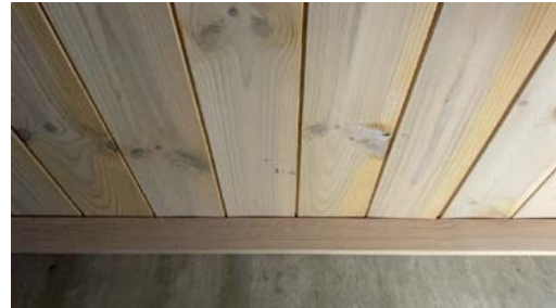
Silikonrester i himling over overskap på innredning
