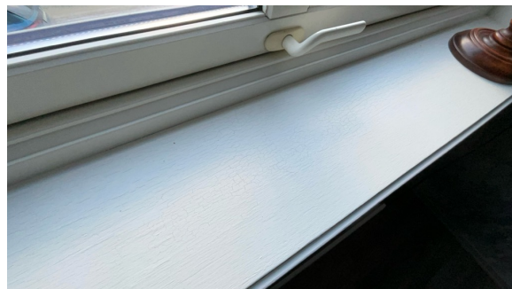
Oppsprukket utforing på soverom
