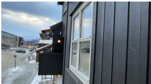
Utvendig oversiktsbilde. Slitte overflater
