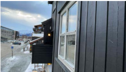
Utvendig oversiktsbilde. Slitte overflater
