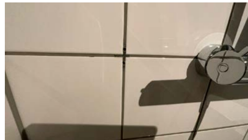
Eldre skruerull i veggflis inne i dusj uten silikon fylling
