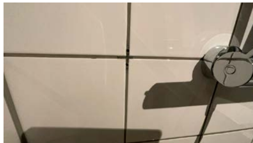
Eldre skruehull i veggflis inne i dusj uten silikon fylling
