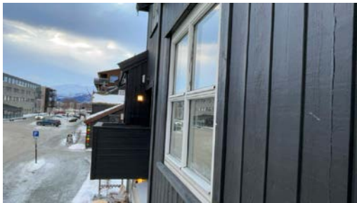
Utvendig oversiktsbilde. Slitte overflater
