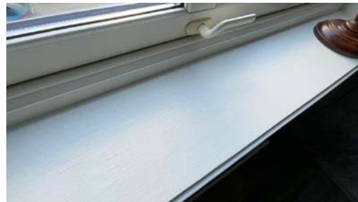
Oppsprukket utforing på soverom
