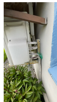
- Isolasjon på utvendige rør er forviftret.
