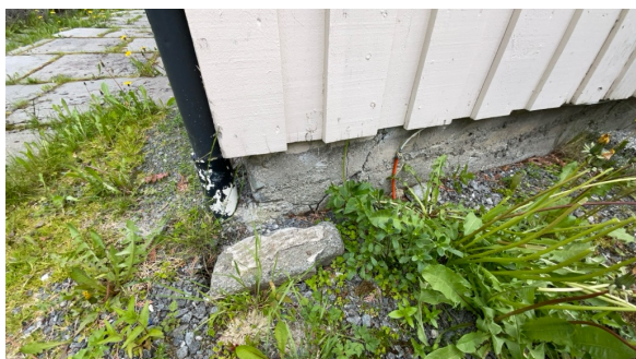
Sprekk i grunnmur mot oversiden
