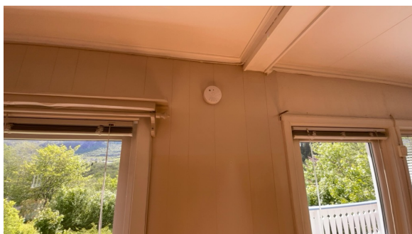
Brannmelder i 1. etasje
