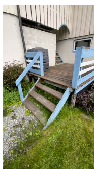
Trapp til terrasse mangler håndløper. Det er krav til rekkverk/håndløper
