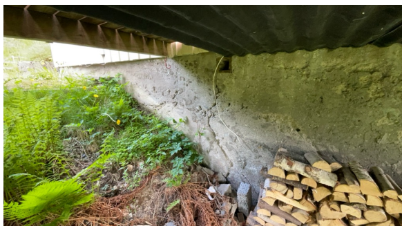
Sprekk i grunnmur på siden mot verandaen.
