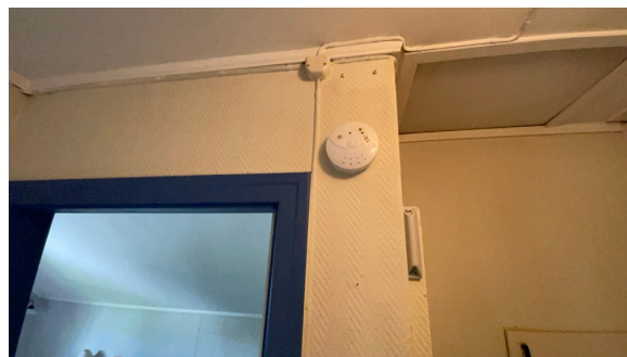
Brannmelder i 2. etasje
