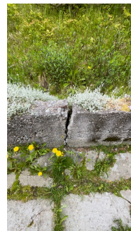
Stor sprekke i støttemur ovenfor boligen
