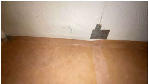
Synlige skader på vegg i dusj
