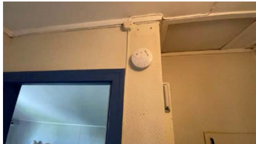
Brannmelder i 2. etasje
