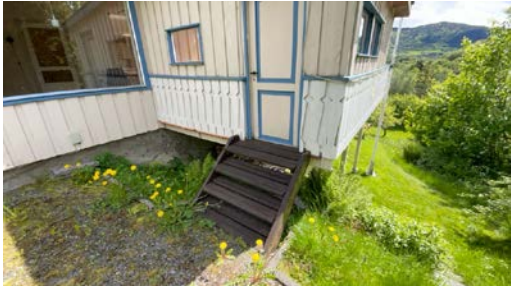
Trapp ved veranda mangler rekkverk
