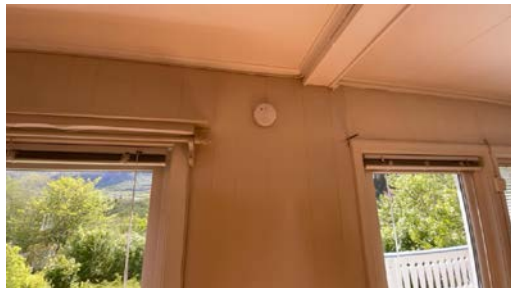
Brannmelder i 1. etasje
