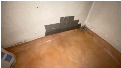
Synlige skader på vegg i dusj
