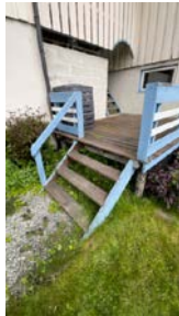
Trapp til terrasse mangler håndløper. Det er krav til rekkverk/håndløper
