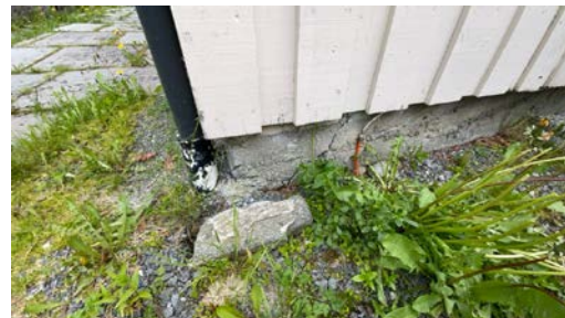
Sprekk i grunnmur mot oversiden
