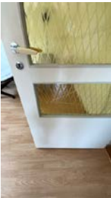
Sprekk i glass på dør til stue fra gang i 1. etasje
