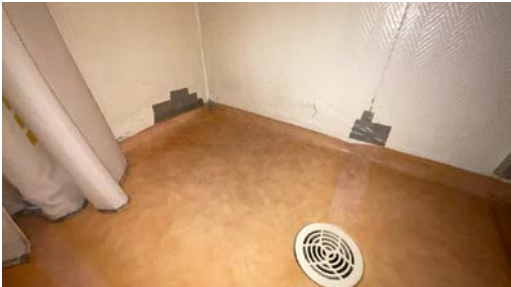
Synlig skade i vegg inne i dusj
