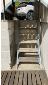
Trapp ved garasje mangler tilstrekkelig sikring/håndløper
