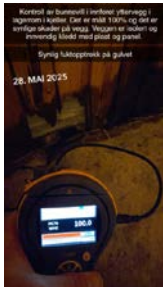
Kontroll av bunnsvill i innforet yttervegg i lagerrom kjeller. Det er målt 100 % og det er synlige skader. Veggene er isolert, innvendig kledd med plast og panel.
