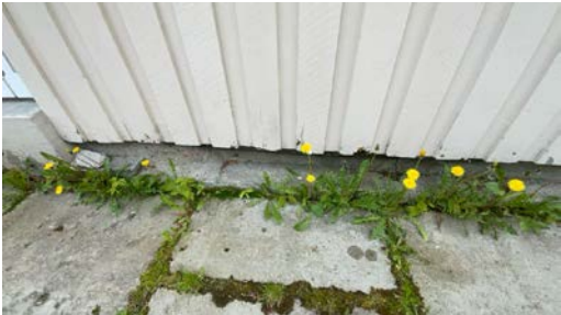
Synlig råteskade på kledning ved inngang
