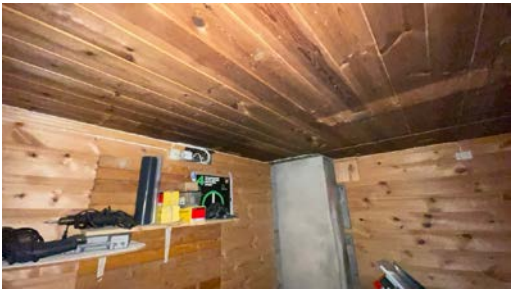
Himling i verksted er sotskadet etter brann som tidligere har vært i kjeller for lang tid siden. Hele kjelleren er bygget om i ettertid.
