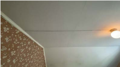
Sprekk i plateskjøt himling på soverom 1 i 2. etasje
