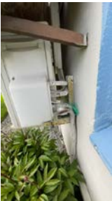
- Isolasjon på utvendige rør er forviftret.
