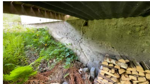
Sprekk i grunnmur på siden mot verandaen.
