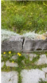
Stor sprekke i støttemur ovenfor boligen
