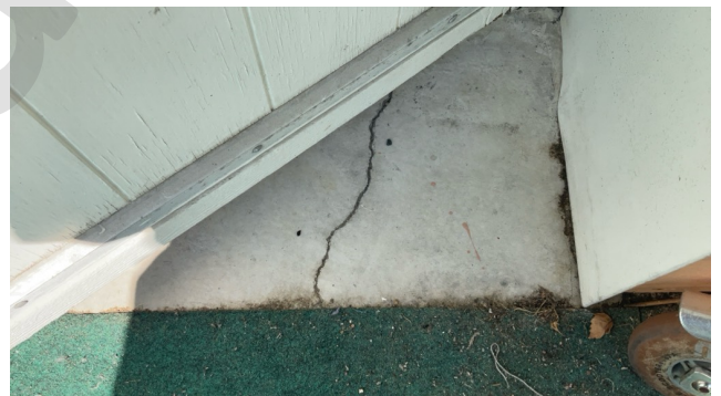
Sprekk i betongen.
