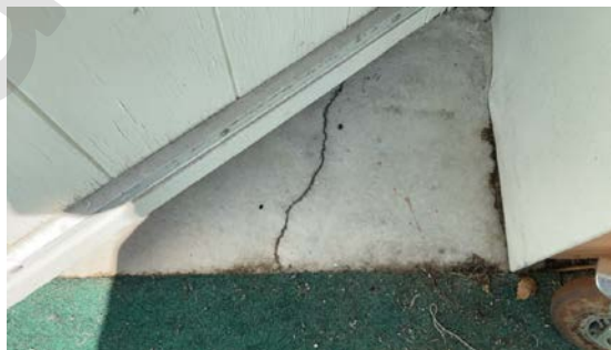
Sprekk i betongen.
