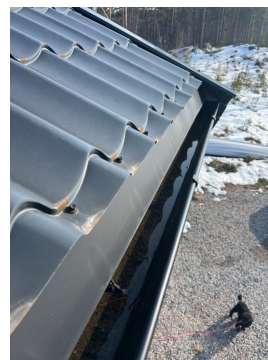
Stående vann i renne med lekkasje over inngangsparti.
