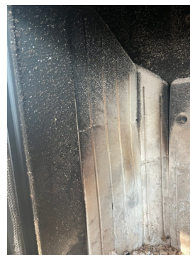
Sprekker i ildfaste steiner i ovnen.
