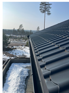
Manglende snøfangere og feil fall på renne.
