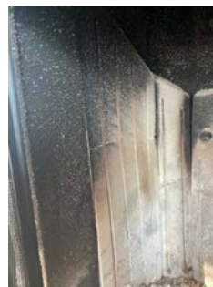
Sprekker i ildfaste steiner i ovnen.
