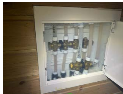
Fordelerskap på bad
