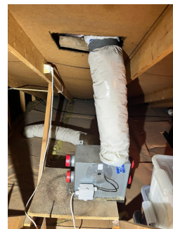
Ikke tett rundt takgjennomføringer
