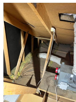
Fuktsvelling på plate under avtrekksvifte.
