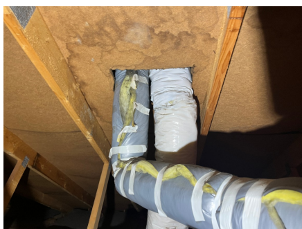
Ikke tett rundt takgjennomføringer
