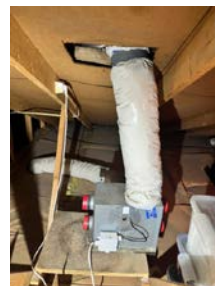
Ikke tett rundt takgjennomføringer
