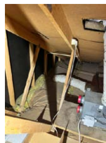
Fuktsvelling på plate under avtrekksvifte.
