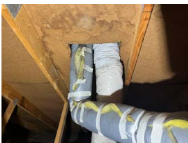
Ikke tett rundt takgjennomføringer
