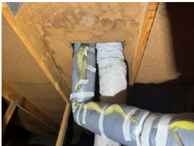
Ikke tett rundt takgjennomføringer
