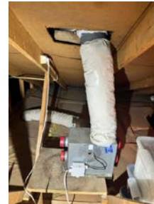
Ikke tett rundt takgjennomføringer
