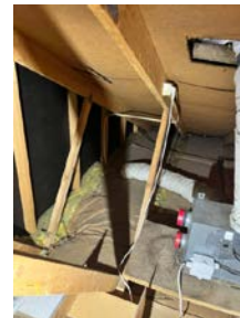
Fuktsvelling på plate under avtrekksvifte.
