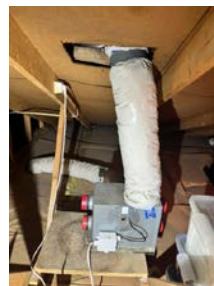
Ikke tett rundt takgjennomføringer
