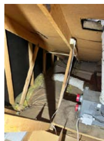
Fuktsvelling på plate under avtrekksvifte.
