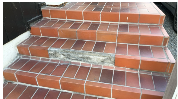
Skader på overflater på trapp.
