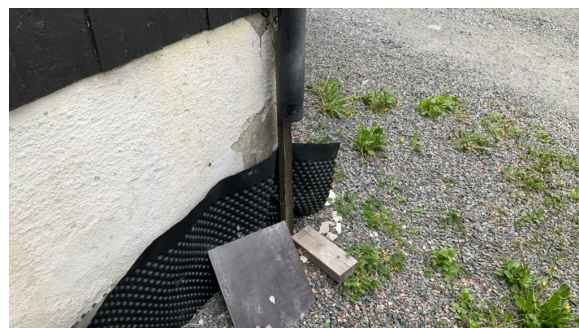
Takvannet ledes ikke vekk fra bygningen. Takvann som ikke ledes vekk fra bygning påfører konstruksjonene (ringmur, grunnmur, drenering og fuktsikring) unødvendig høy fuktbelastning og skader kan oppstå over tid.
