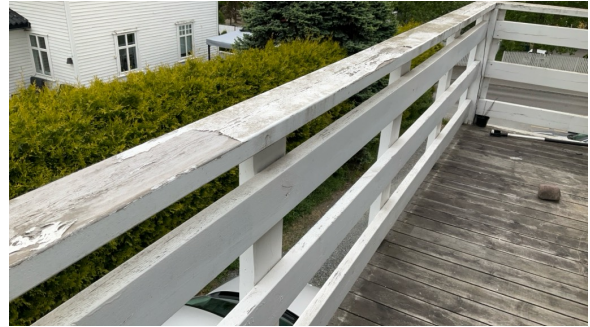
Konstruksjoner/overflater har vedlikeholdsbehov.
