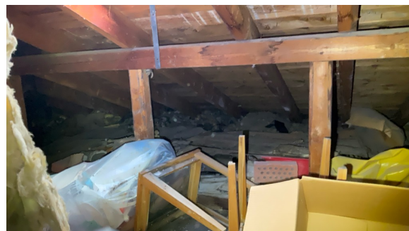
Isolasjon på loftet ligger ujevnt.
