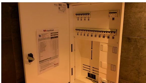
Sikringsskap plassert på bad i kjeller.
