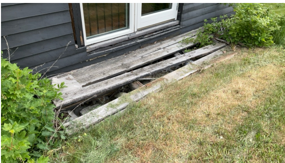
Platting utenfor ene soverommet må fjernes.
