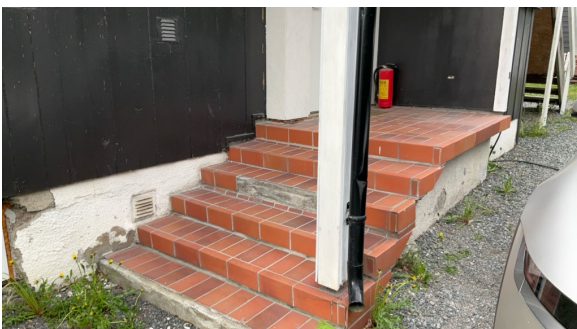
Det er ikke montert rekkverk. Rekkverk må monteres for å lukke avviket.
