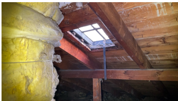
Fuktmerker er registrert ved gjennomføringer.
