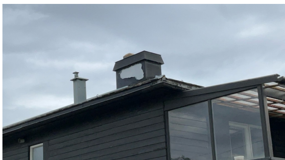
Flassing på takrenner/beslag.
