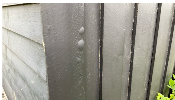
Områder med bobler som følge av feil type overflatebehandling av kledning vil være mer utsatt for fuktskader da det kan komme fukt inn bak overflatebehandling.
