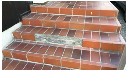
Skader på overflater på trapp.
