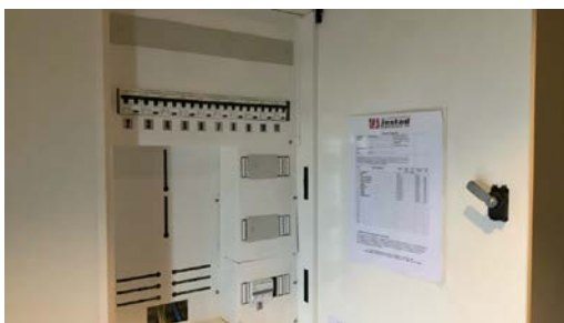
Sikringsskap plassert i gang i 2. etasje.
