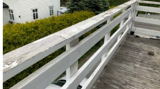
Konstruksjoner/overflater har vedlikeholdsbehov.
