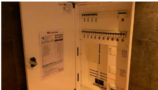
Sikringsskap plassert på bad i kjeller.
