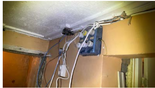
Løse ledninger og ufagmessig arbeid.
