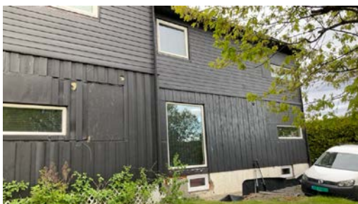
Det anbefales å skifte kledning rundt hele boligen. Åpninger i konstruksjonene rundt vinduer medfører at det kan komme fukt inn i konstruksjonene. Dette vil over tid medføre skader i konstruksjonene.
