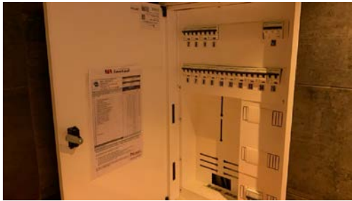
Sikringsskap plassert på bad i kjeller.
