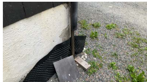
Takvannet ledes ikke vekk fra bygningen. Takvann som ikke ledes vekk fra bygning påfører konstruksjonene (ringmur, grunnmur, drenering og fuksikring) unødvendig høy fuktbelastning og skader kan oppstå over tid.
