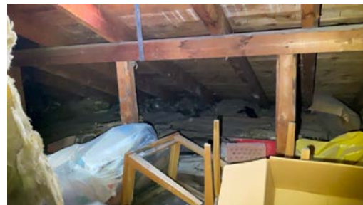
Isolasjon på loftet ligger ujevnt.
