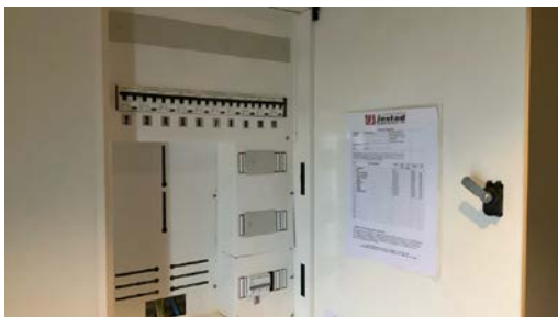
Sikringsskap plassert i gang i 2. etasje.
