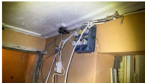
Løse ledninger og ufagmessig arbeid.
