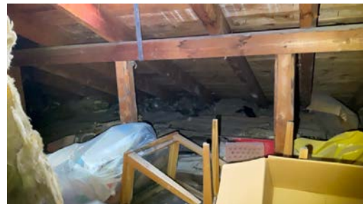
Isolasjon på loftet ligger ujevnt.
