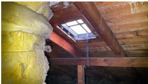
Fuktmerker er registrert ved gjennomføringer.
