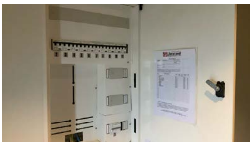
Sikringsskap plassert i gang i 2. etasje.
