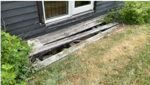
Platting utenfor ene soverommet må fjernes.
