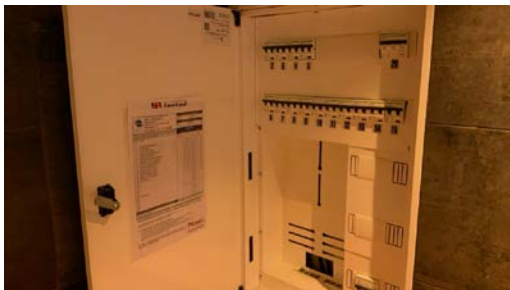
Sikringsskap plassert på bad i kjeller.
