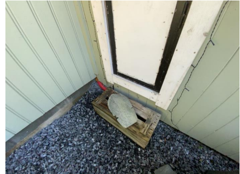
Det er påvist spredte råteskader i bordkledningen.
