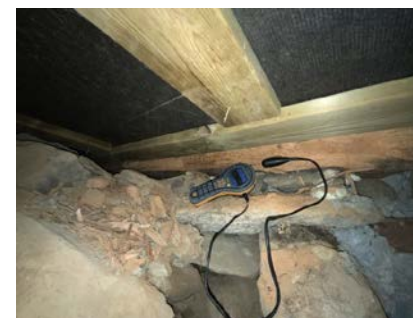
Synlig råteskadet kantbjelke, dog ingen høy fukt ble målt på befaringdagen.
