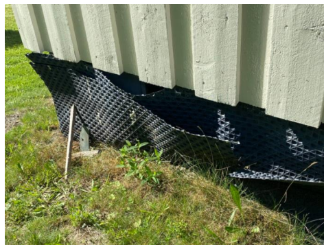
Mangler klemlist/innpussing av drensplast på grunnmur
