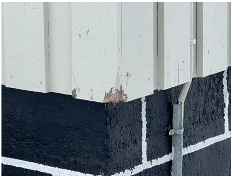
Sprekk i kledningsbord
