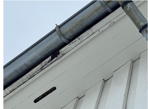
Råte i takfot og forkant
