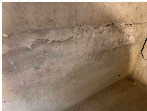
Sprekker i kjellermur
