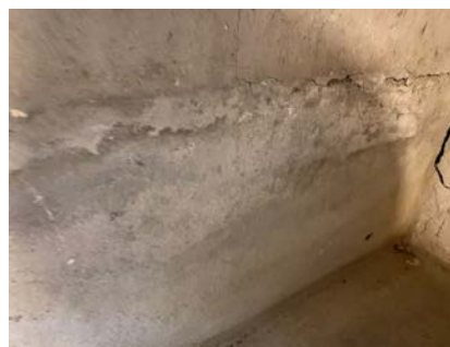
Sprekker i kjellermur
