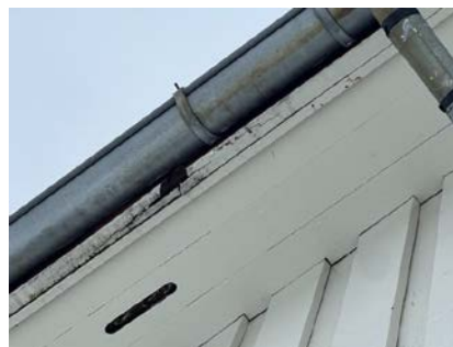
Råte i takfot og forkant
