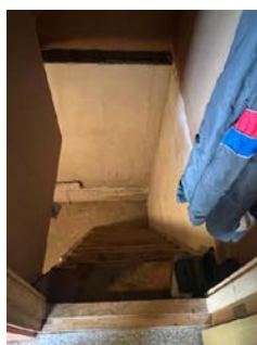
Trapp til kjeller har avvik og er svært bratt
