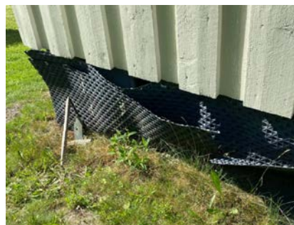
Mangler klemlist/innpussing av dreneringsplatt på grunnmur
