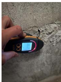
Fuktutslag på vegger mot terreng og gulv mot grunn
