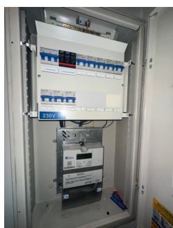
Sikringsskap med automatsikringer.
