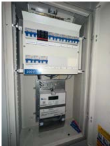
Sikringsskap med automatsikringer.
