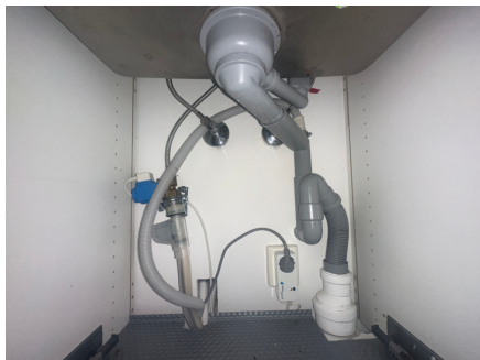
Røropplegg i kjøkkenbenk med Waterguard
