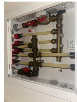
Samleskap med rørkurser og stoppekraner
