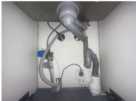
Røropplegg i kjøkkenbenk med Waterguard
