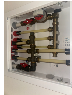
Samleskap med rørkurser og stoppekraner
