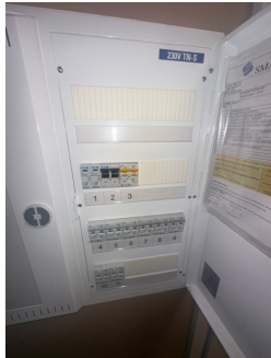
Sikringskap med automatsikringer.
