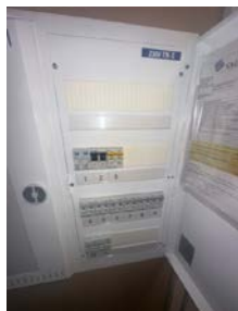
Sikringsskap med automatsikringer.
