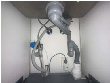
Rørpropplegg i kjøkkenbenk med Waterguard
