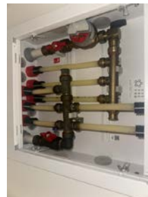
Samleskap med rørkurser og stoppekraner
