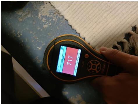
Indikert høye fuktverdier i betonggulv i bod.
