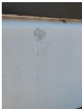
Sprekker og avflassing av maling.
