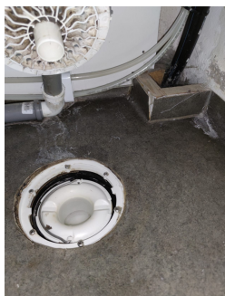
Bilde av sluk og utett hjørneløsning.
