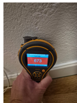
Indikert høye fuktverdier i murvegg på soverom.
