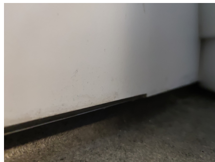
Ujevnt monterte plater.
