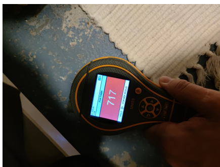
Indikert høye fuktverdier i betonggulv i bod.
