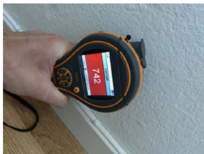
Indikert høye fuktverdier i murvegg på soverom.
