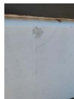
Sprekker og avflassing av maling.
