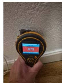
Indikert høye fuktverdier i murvegg på soverom.
