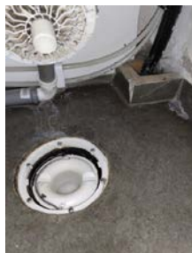
Bilde av sluk og utett hjørneløsning.
