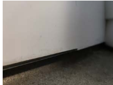
Ujevnt monterte plater.
