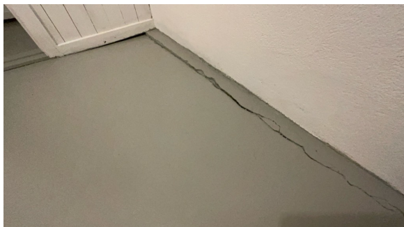
Sprekk i bod.
