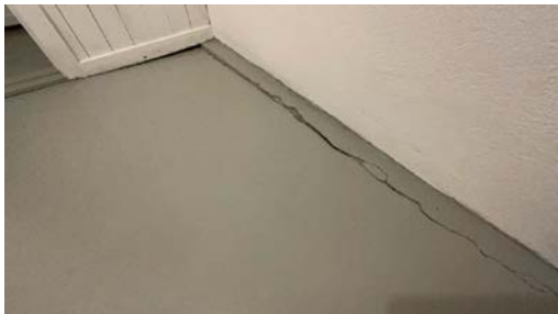
Sprekk i bod.
