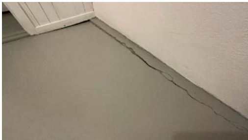
Sprekk i bod.
