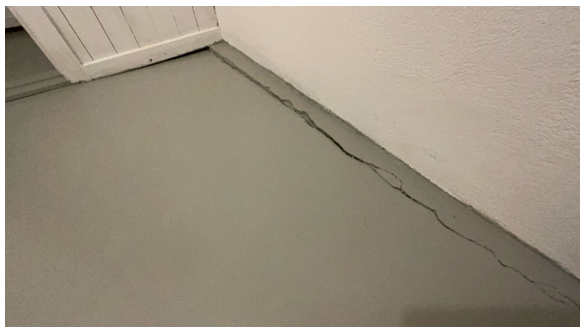
Sprekk i bod.
