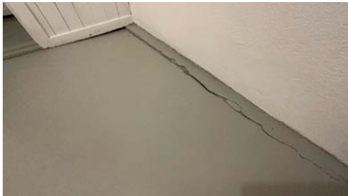
Sprekk i bod.
