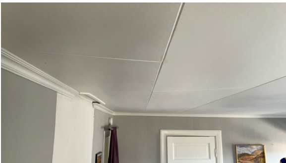
Himlingsplater i stue i 2. etasje er løse.
