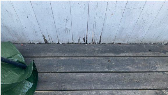
Råte i rekkverk i 2. etasje.
