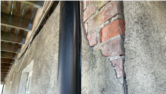
Frostsprengning på nedløpsrør.
