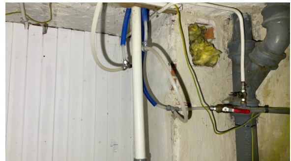
Noen vannrør i plast.
