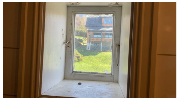
Noe fuktmerker/løs maling på vindu.
