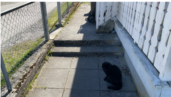
Lokalt fall mot grunnmur.
