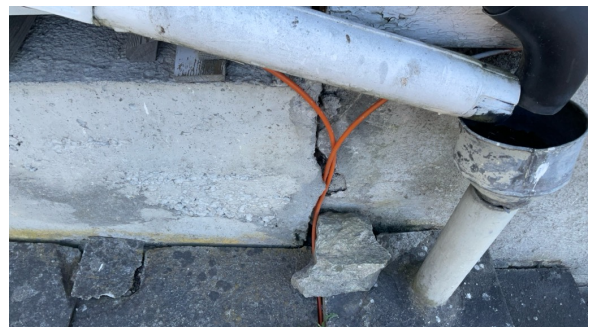
Sprekk i mur mot trapp.
