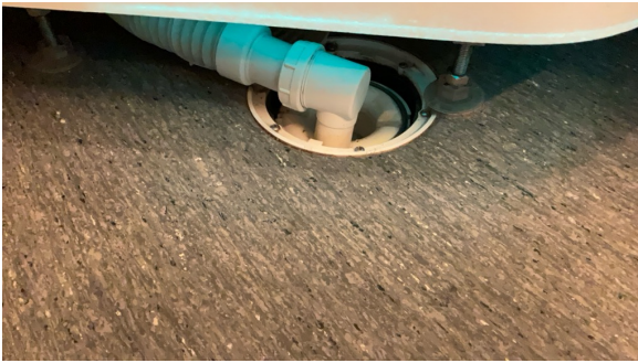
Sluk under dusjkabinett.
