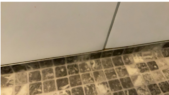
Noe fuktsvelling i nedre kant på våtromsplater.
