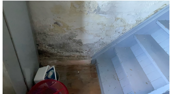
Fukt på vegg i underetasjen.
