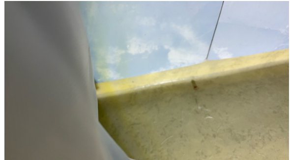
Fuktsvelling på veggplater i dusjsonen
