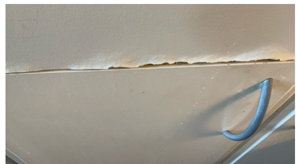
Fuktsvelling på front ved vask
