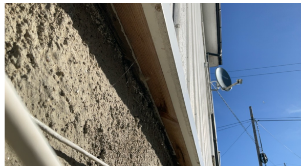
Manglende lufting i nedre kant av kledning.
