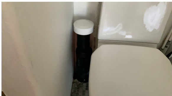
Lufting av avløp med vakumsventil på toalettrom.
