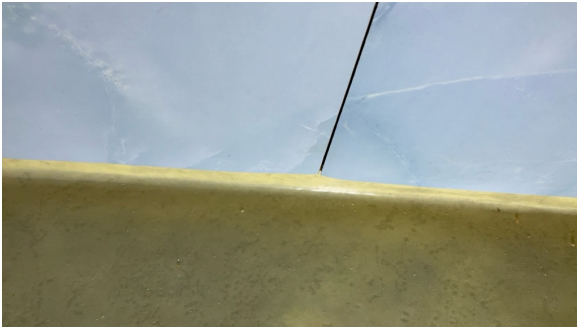
Beggplater er fuget med Silicon i nedre kant mot gulv.
