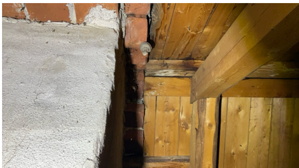
Noe kondensmerker veg gjennomføring til pipe.
