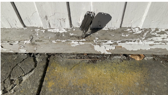
Råte i buunlist og kort avstand fra underkant treverk til terreng.
