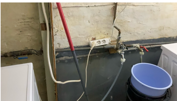
Noen fuktmerker/løs maling på vegger.
