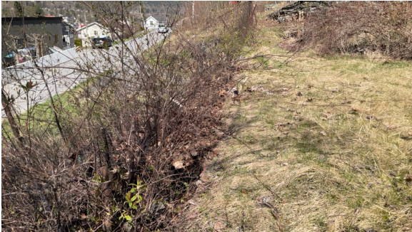
Dærlig/manglende gjerde på støttemur.
