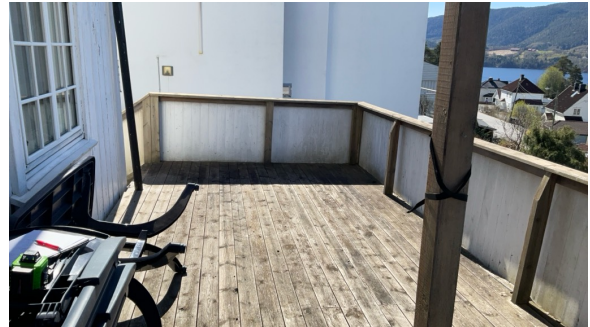
12cm høydeforskjell på veranda i 1. etasje.
