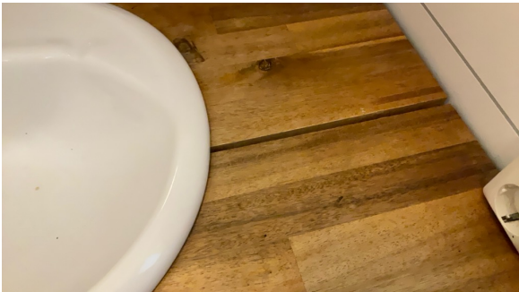
Sprekk i benkeplate ved vask.
