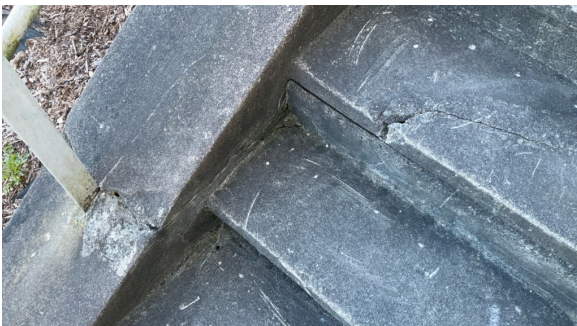
Sprekk i betongtrapp.
