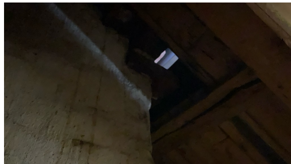
Manglende undertetting i takgjennoimføringer for piper.
