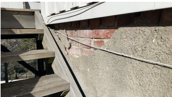
Grunnmur i murstein med utvendig puss. Det er en del løs puss og manglende puss.
