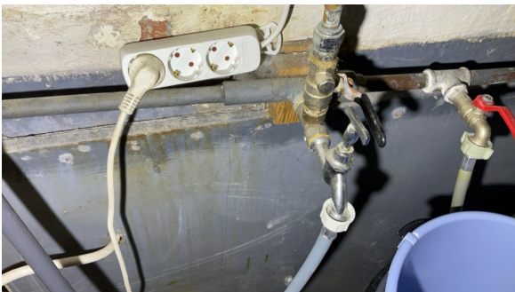
Noe gammelt opplegg på vannrør.
