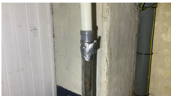
Overgang tettet med tape.
