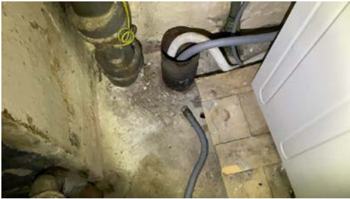
Noe ukurant avløp fra vaskemaskiner.
