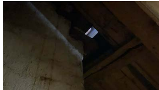
Manglende undertetting i takgjennomføringer for piper.
