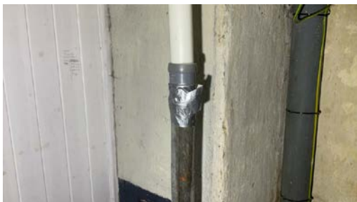
Overgang tettet med tape.
