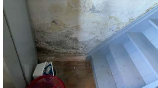
Fukt på vegg i underetasjen.
