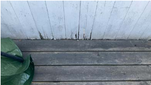
Råte i rekkverk i 2. etasje.
