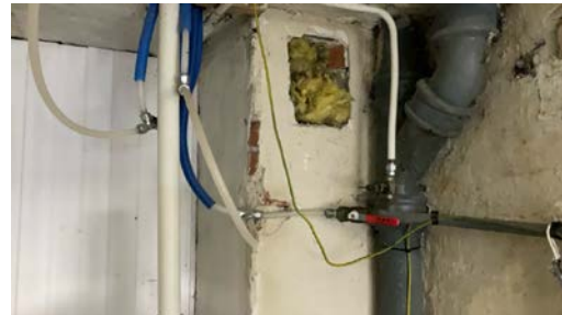
Det er hull i pipe som kun er tettet med isolasjon.
