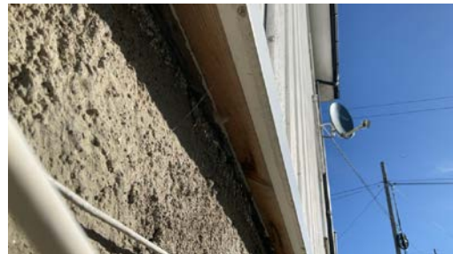
Manglende lufting i nedre kant av kledning.
