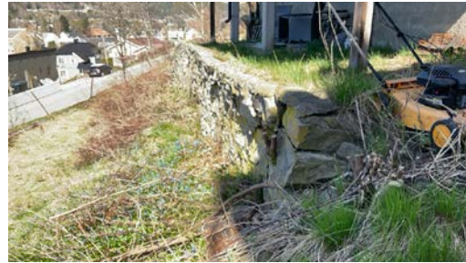
Støttemur i naturstein med skjevheter.
