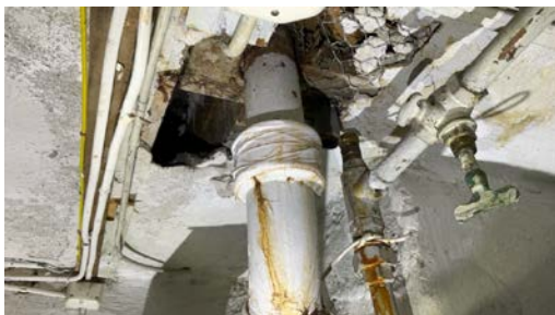
Skade i tak ved rørgjennomføring av rør i vaskerom i kjeller.
