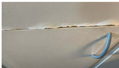
Fuktsvelling på front ved vask
