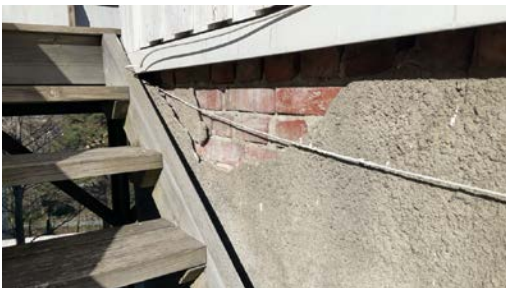
Grunnmur i murstein med utvendig puss. Det er en del løs puss og manglende puss.
