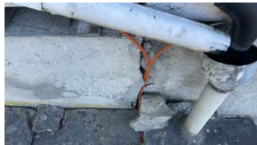
Sprekk i mur mot trapp.
