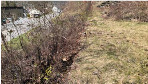
Dærlig/manglende gjerde på støttemur.
