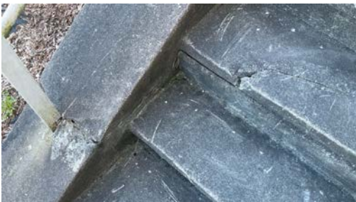
Sprekk i betongtrapp.
