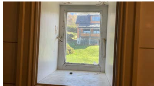
Noe fuktmerker/løs maling på vindu.
