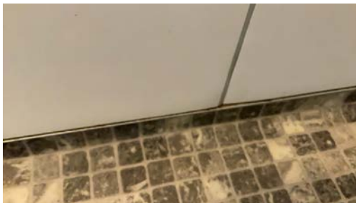
Noe fuktsvelling i nedre kant på våtromsplater.
