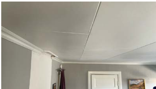
Himlingsplater i stue i 2. etasje er løse.
