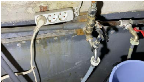
Noe gammelt opplegg på vannrør.
