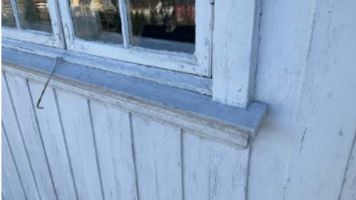
Generelt slitte vinduer.
