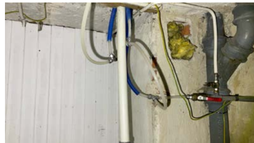
Noen vannrør i plast.
