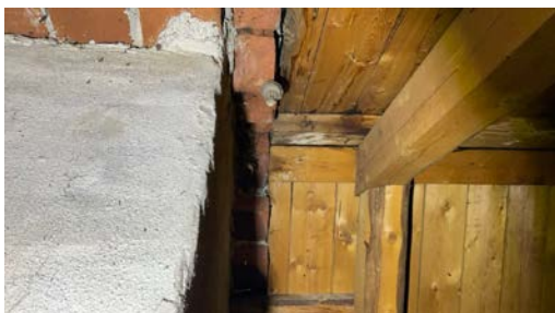
Noe kondensmerker veg gjennomføring til pipe.
