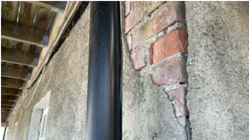
Frostsprengning på nedløpsrør.
