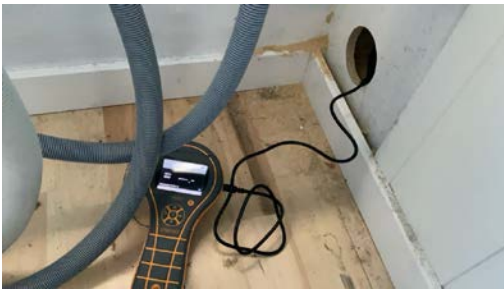
Fuktmåling i konstruksjon mot dusjsone.
