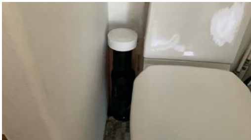
Lufting av avløp med vakumsventil på toalettrom.
