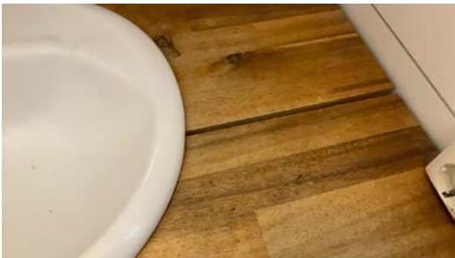
Sprekk i benkeplate ved vask.
