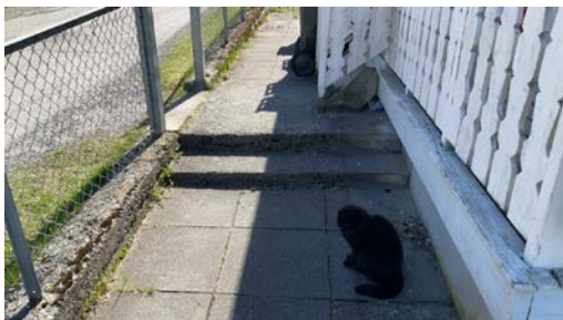
Lokalt fall mot grunnmur.
