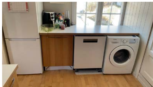
Opplegg til vaskemaskin og oppvaskmaskin
