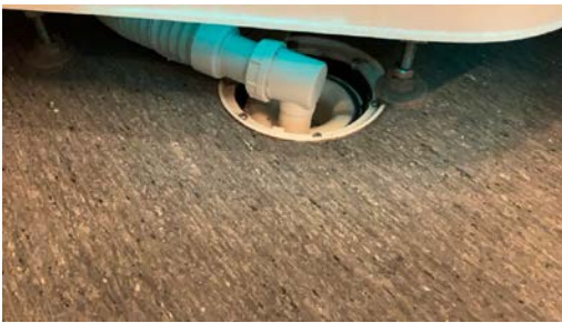
Sluk under dusjkabinett.
