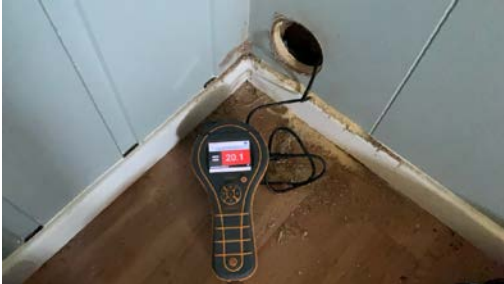
Fuktmåling i alkove i underetasjen.
