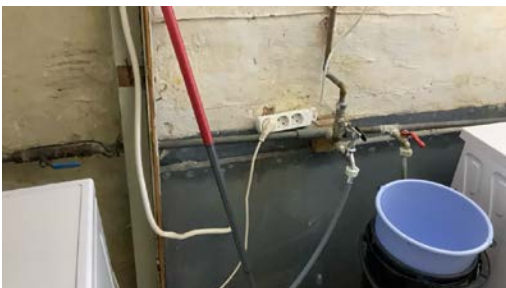
Noen fuktmerker/løs maling på vegger.
