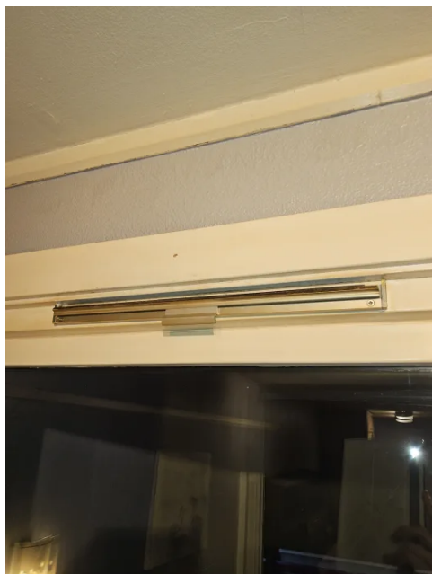
Bilde viser spalteventil i vindu.
