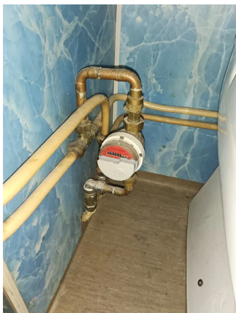
Bilde viser vannmåler.
