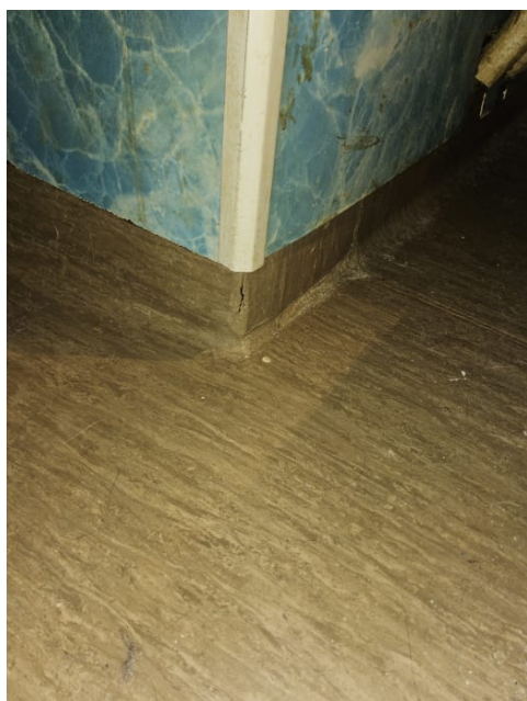
Bilde viser sprekk i golvbelegg.
