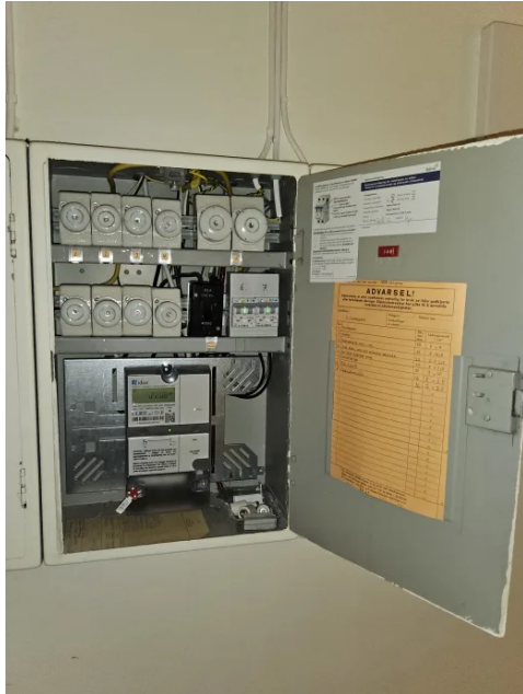
Bilde viser sikringsskap.
