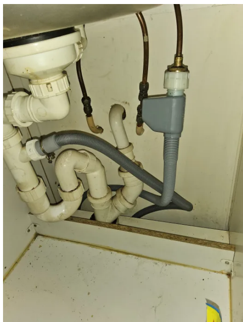
Bilde viser avløpsrør under oppvaskkum på kjøkken.
