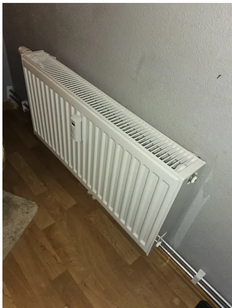
Bilde viser radiator.
