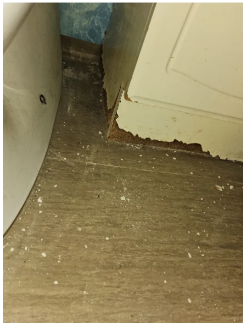
Bilde viser fuktskadet innredning.
