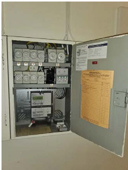
Bilde viser sikringsskap.
