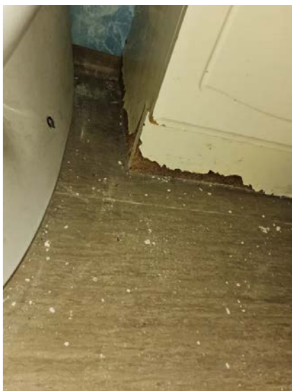
Bilde viser fuktskadet innredning.
