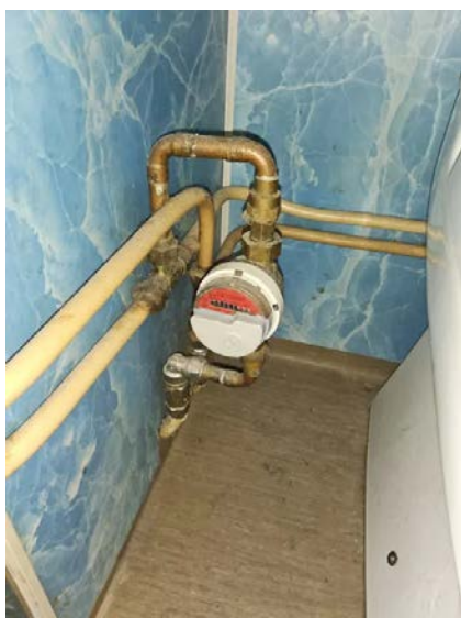
Bilde viser vannmåler.
