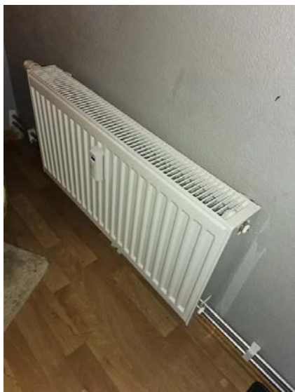
Bilde viser radiator.
