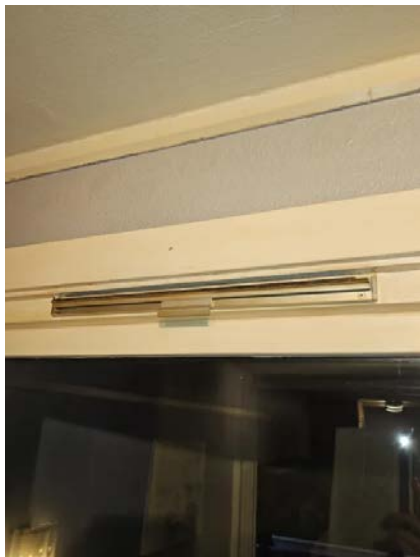
Bilde viser spalteventil i vindu.
