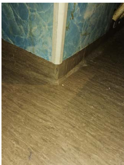
Bilde viser sprekk i gulvbelegg.
