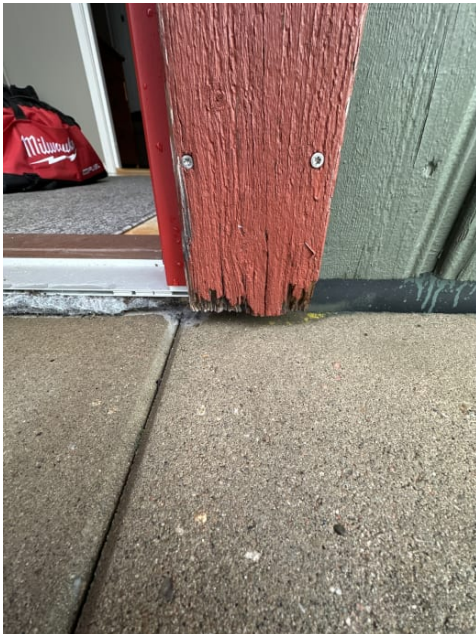
Råteskade på nedre del av omramming ved ytterdør.
