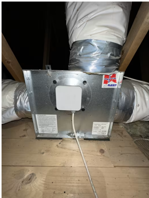
Viser vifte plassert på loft.
