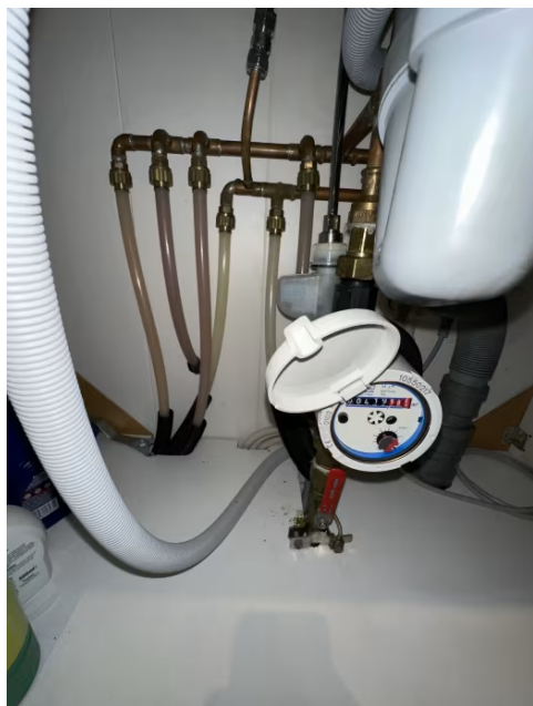
Viser vanninntak, hovedstoppekran, vannmåler og vannrør.
