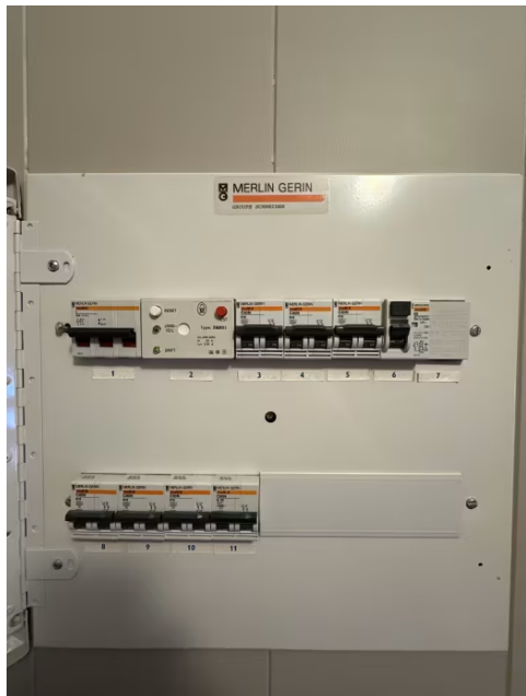
Viser sikringskap plassert i gang.
