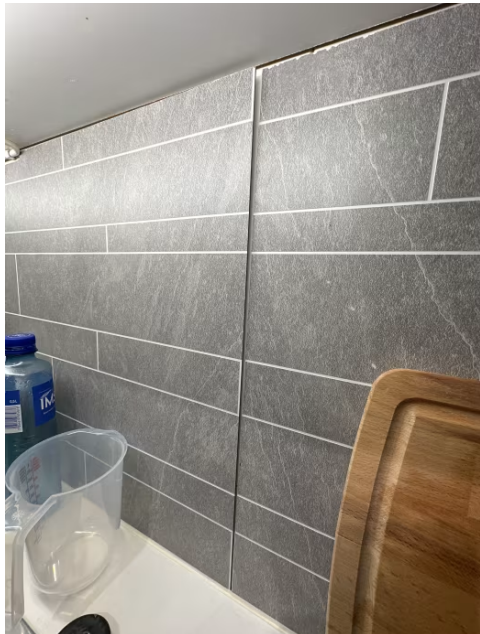
Viser løse plater i benkerygg.
