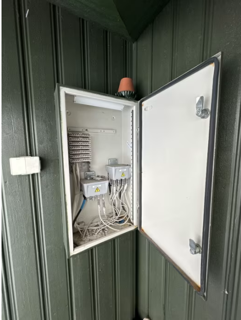
Viser utvendig svakstrømskap ved terrasse.
