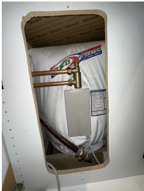
Viser bereder plassert i kjøkkenskap.
