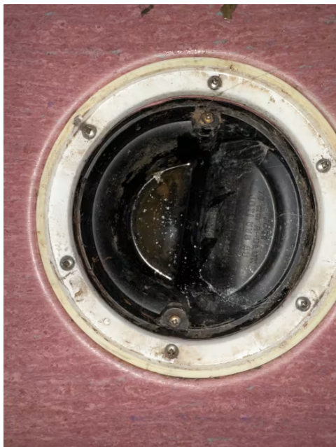
Viser sluk i dusjsonen.
