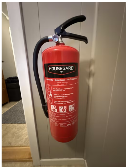
Vser brannslukningsapparat i gang.
