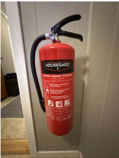
Vser brannslukningsapparat i gang.
