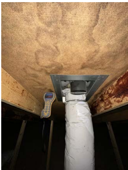
Det er påvist fuktmerker i undertak ved gjennomføring til ventilasjonsrør. Ved bruk av fuktmåler ble det registrert forhøyede verdier.
