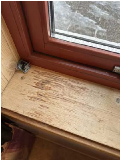
Utforing i bod med mindre fuktskjolder.
