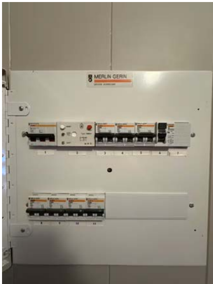
Viser sikringsskap plassert i gang.
