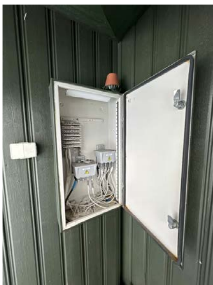
Viser utvendig svakstrømskap ved terrasse.
