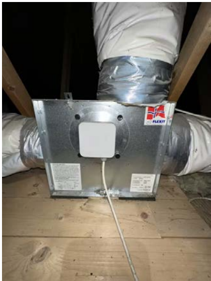
Viser vifte plassert på loft.
