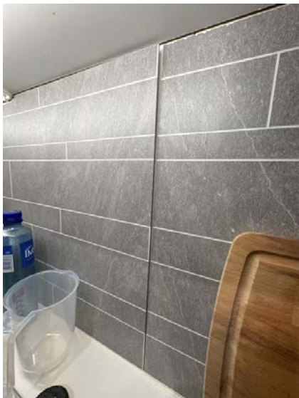
Viser løse plater i benkerygg.
