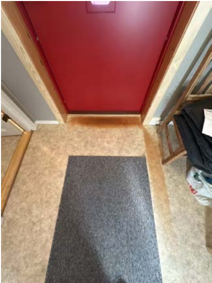
Viser gulbrune flekker på vinylgulv.
