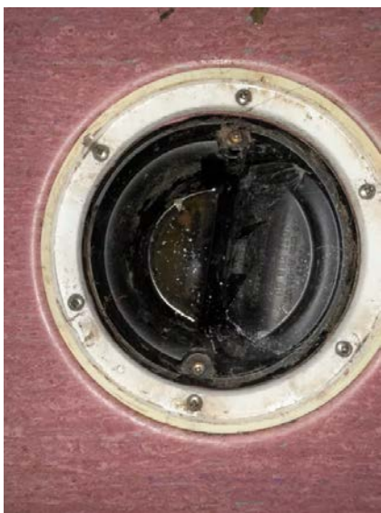
Viser sluk i dusjsonen.
