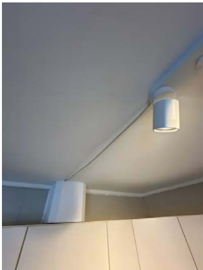
Kabel til lampe på kjøkkenet er ikke forsvarlig festet.
