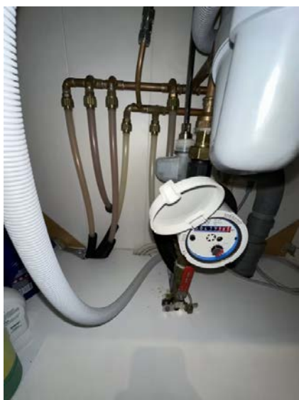
Viser vanninntak, hovedstoppekran, vannmåler og vannrør.
