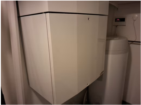
Ventilasjonsaggregatet er plassert på bod/teknisk rom.
