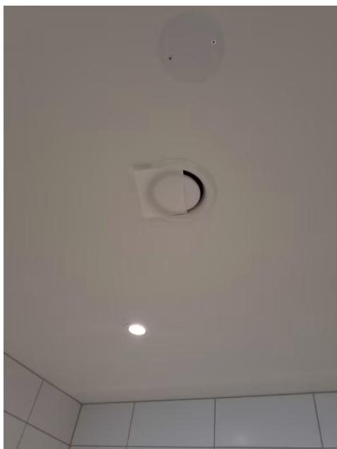
Avtrekkseffekten er testet med papir.
