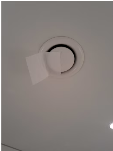
Avtrekkseffekten er testet med papir.
