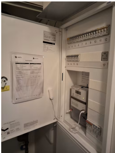
Sikringsskap er plassert i bod/teknisk rom.
