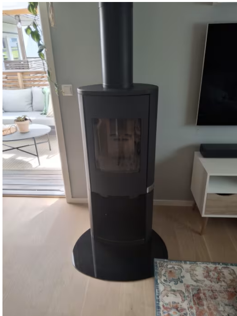
Vedovn med glassdør i stue.
