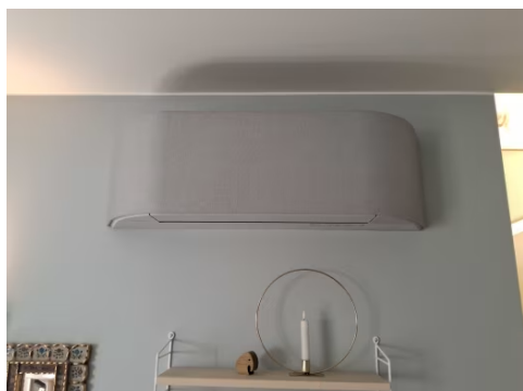
Varmepumpe er plassert i stue.
