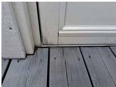
Råteskade på balkongdør.
