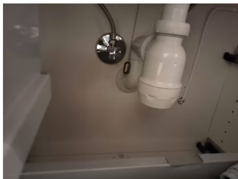
Leiligheten har synlige avløpsrør av plast.
