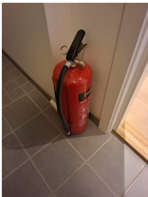
Brannslukningsapparat er plassert i bod/teknisk rom.
