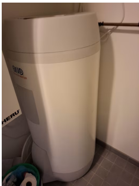
Varmtvannsbereder er plassert på bod/teknisk rom.
