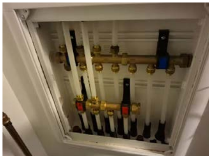
Fordelerskap for rør-i-rør er plassert på bod/teknisk rom.
