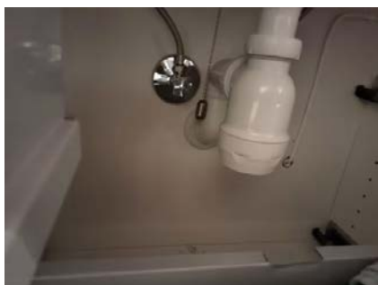
Leiligheten har synlige avløpsrør av plast.
