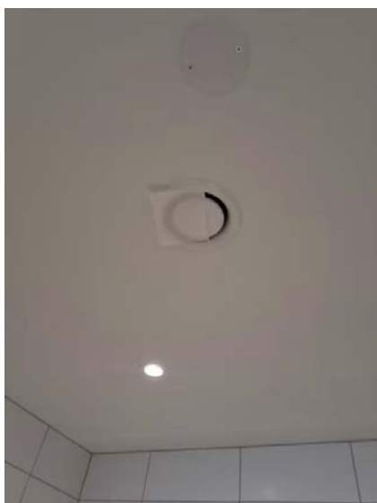
Avtrekkseffekten er testet med papir.
