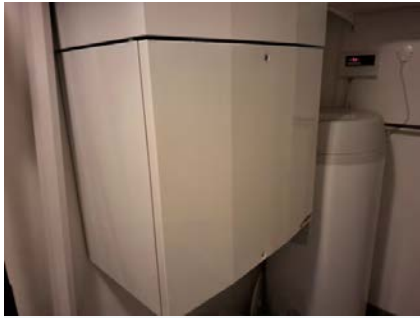
Ventilasjonsaggregatet er plassert på bod/teknisk rom.
