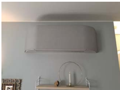
Varmepumpe er plassert i stue.
