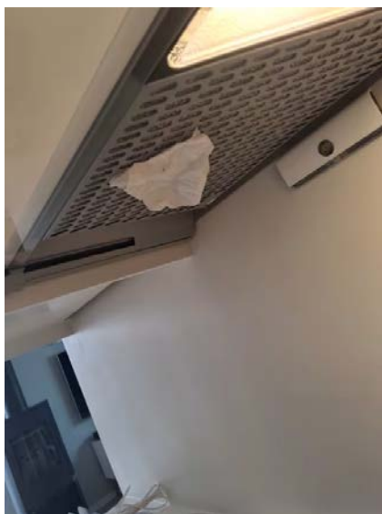
Avtrekkseffekten er kontrollert med papir.
