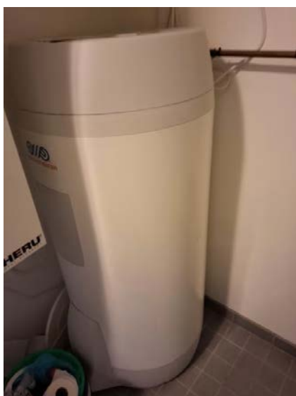
Varmtvannsbereder er plassert på bod/teknisk rom.
