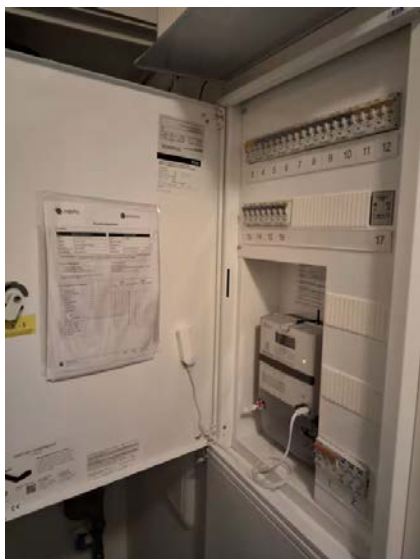
Sikringsskap er plassert i bod/teknisk rom.
