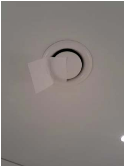
Avtrekkseffekten er testet med papir.
