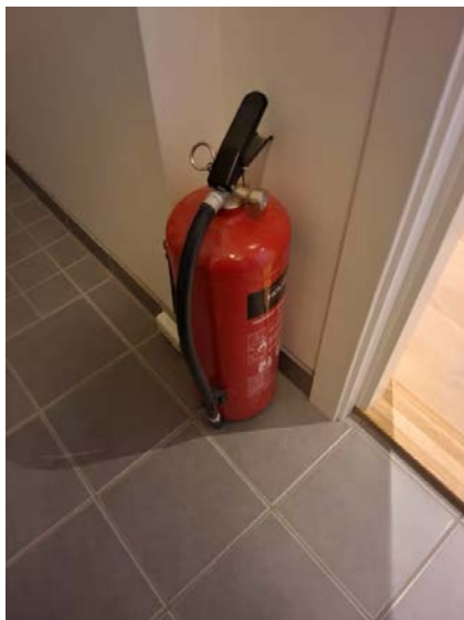
Brannslukningsapparat er plassert i bod/teknisk rom.
