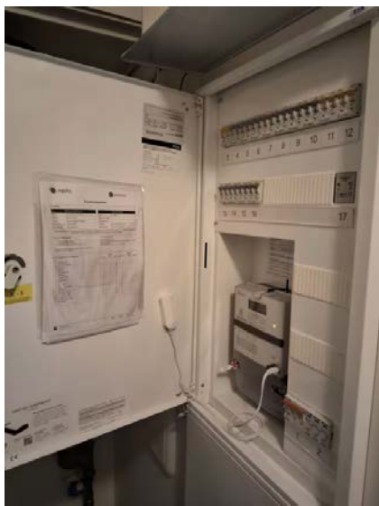
Sikringsskap er plassert i bod/teknisk rom.
