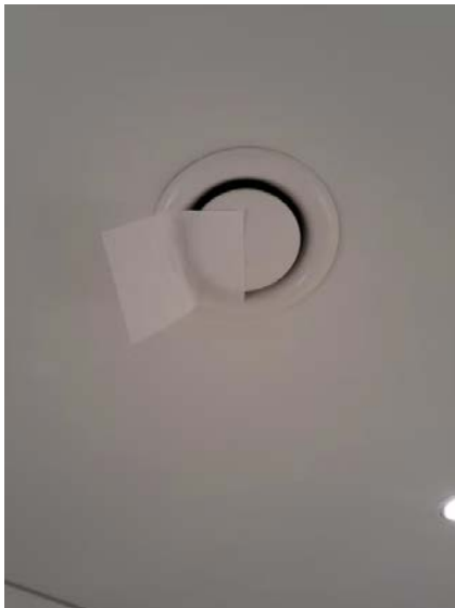
Avtrekkseffekten er testet med papir.
