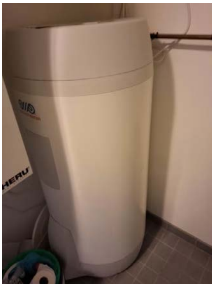
Varmtvannsbereder er plassert på bod/teknisk rom.
