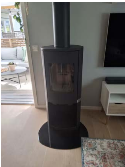
Vedovn med glassdør i stue.
