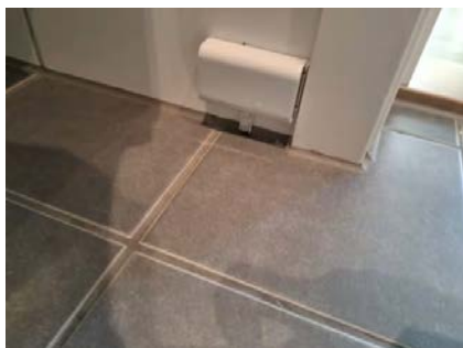
Det er etablert sensor til automatisk vannstopper ved dør.
