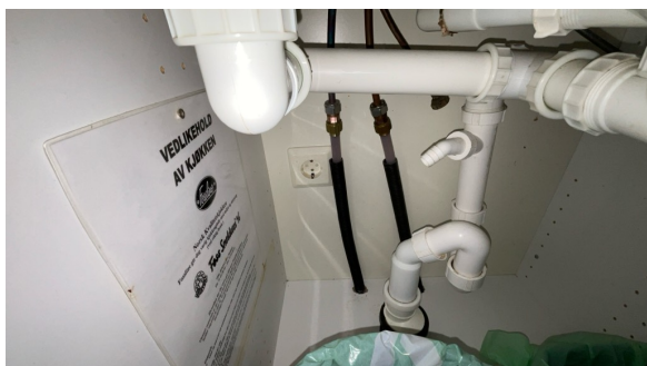
Rør under kjøkkenvask mangler tettemuffer
