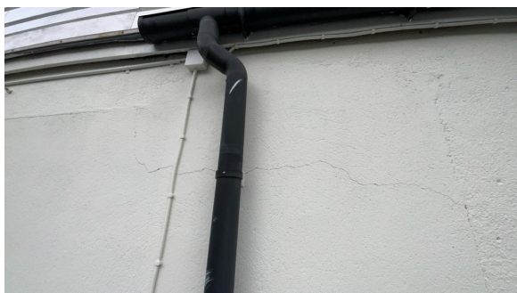
Synlig sprekk i puss ved soverom
