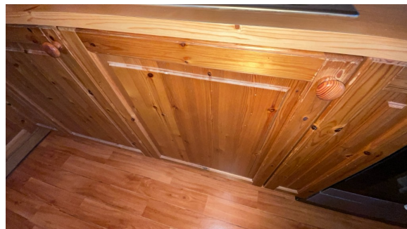
Slitasje på dørfrent ved vask
