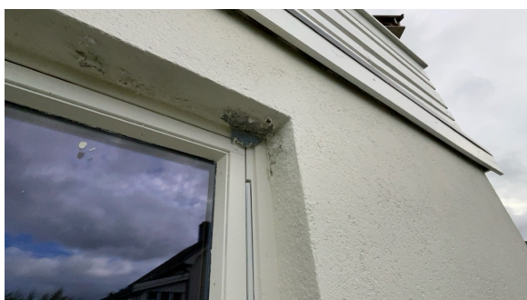
Flassing av maling og saltutslag på puss ved vindu til soverom
