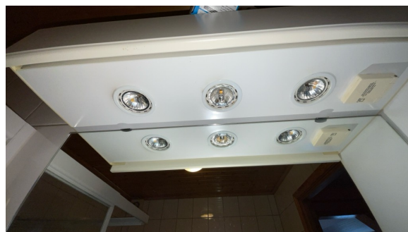
Mangler glass på spotter i lyslist og spotter lyser ikke ved befaringen
