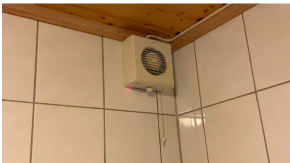
Mekanisk avtrekk på vegg
