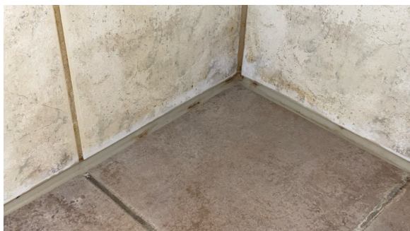
Noe misfarging på silikon/mykfuge og saltutslag på enkelte flisfuger.
