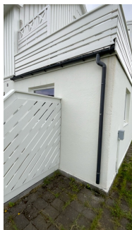
Takrenne med avløp ført til terreng
