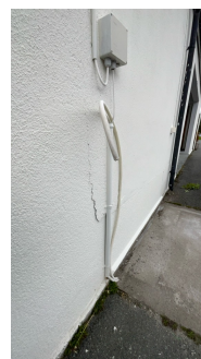
Sprekk/svelling av puss ved soverom
