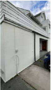
Det er ikke montert takrenne på deler av fremsiden
