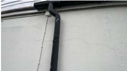
Synlig sprekk i puss ved soverom
