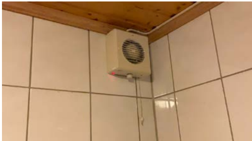
Mekanisk avtrekk på vegg
