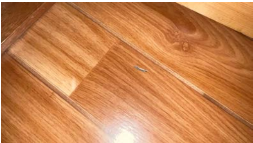
Skade på gulvbelegg i gang ved dør til soverom 2
