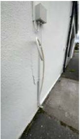
Sprekk/svelling av puss ved soverom
