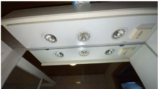
Mangler glass på spotter i lyslist og spotter lyser ikke ved befaringen
