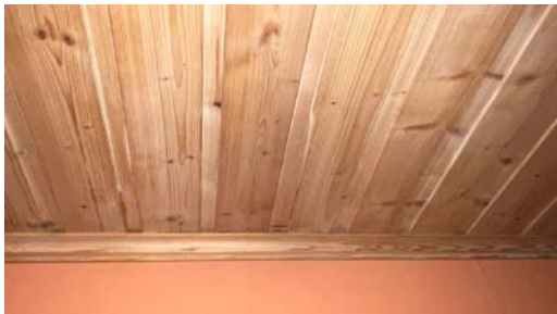
Skade på ett panelbord i himling i gang
