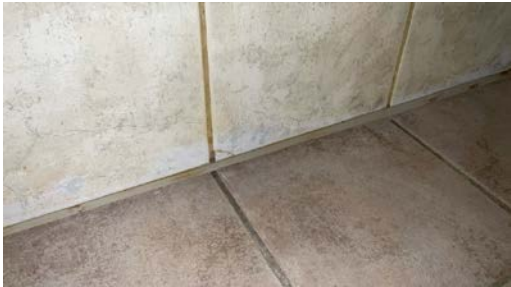
Sprekk i ei flis inne i dusjen ned mot gulvet.
