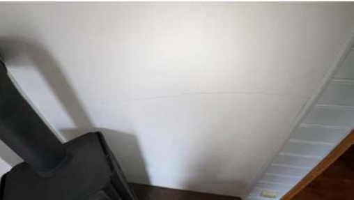
Sprekk i brannmur
