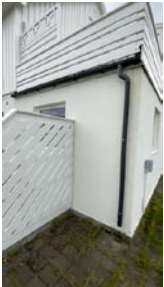
Takrenne med avløp ført til terreng
