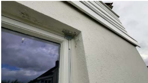
Flassing av maling og saltutslag på puss ved vindu til soverom
