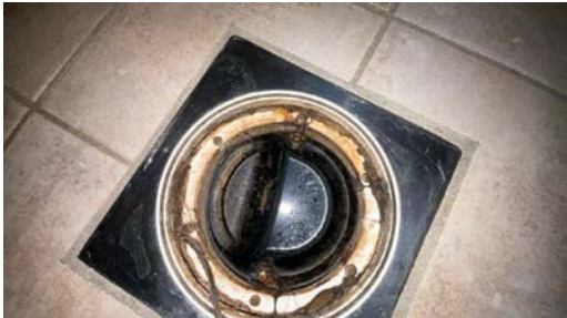
Sluk med synlig membran under klemring
