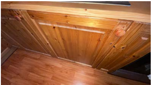
Slitasje på dørfront ved vask
