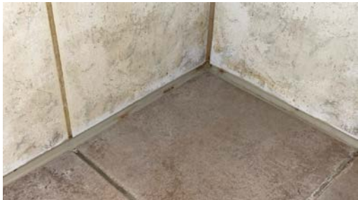
Noe misfarging på silikon/mykfuge og saltutslag på enkelte flisfuger.
