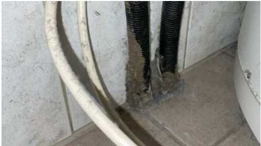
Ingen synlige rørmansjetter på rør opp fra gulv, synlig smøremembran.
