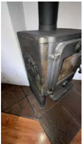
Synlig rust på overflate av vedovn
