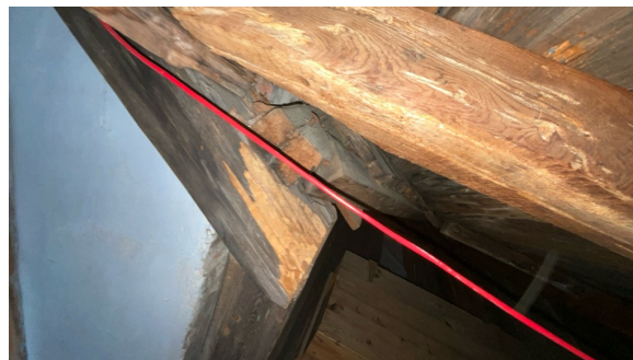
Del av takkonstruksjon, sett fra loft. Spor etter sakadedyr.
