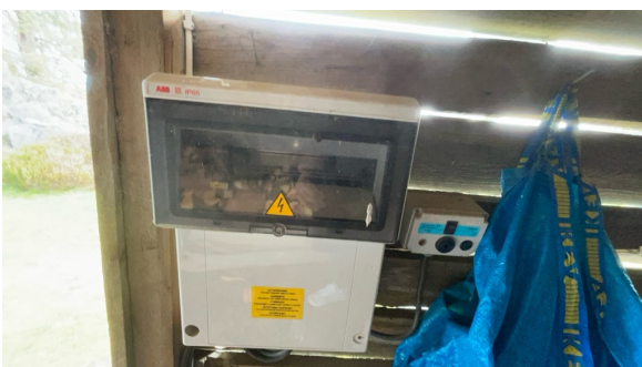
Styreskap til avløpspumpe.
