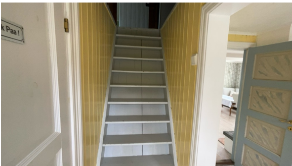
Det er ikke montert veggerekke.
